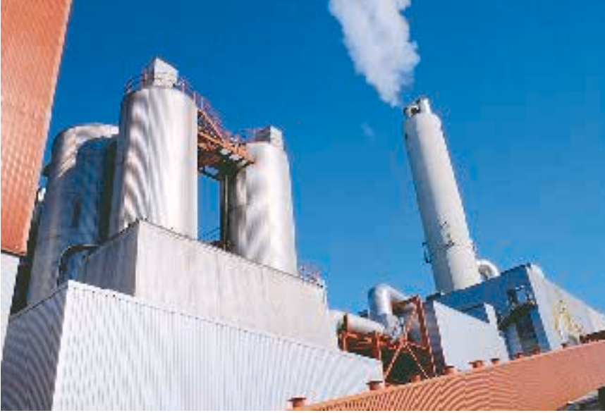
Die Abgasnachreinigungsanlage in der MVA Stellinginger Moor
