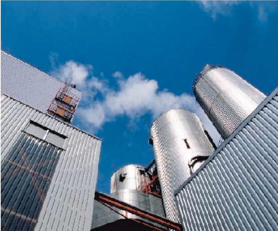
MVA Stelling Moor: Moderner Emissionsschutz garantiert, daß alle gesetzlichen Grenzwerte teilweise deutlich unterschritten werden.
